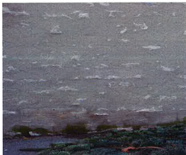
Enduit à pierre presque vue
